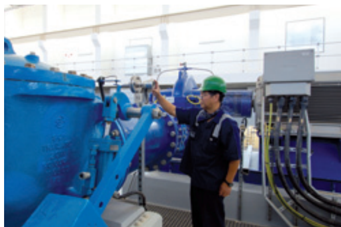
Estación de bombeo de Al Ain, Emiratos Árabes.
