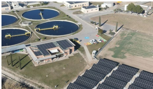
Panneaux solaires installés dans la STEU de Lleida, Espagne.
