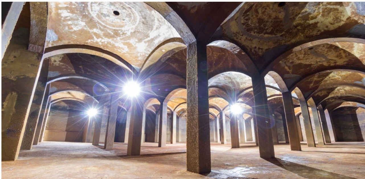
Réservoirs de Santa Isabel à Almería, Espagne.
