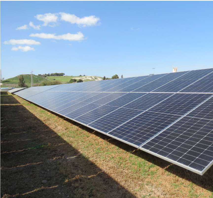
● Placas solares instaladas en la EDAR de Jerez de la Frontera, España.
