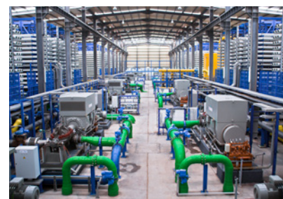
● Interior de la instalación de la desaladora de agua de mar de Mostaganem, Argelia.
