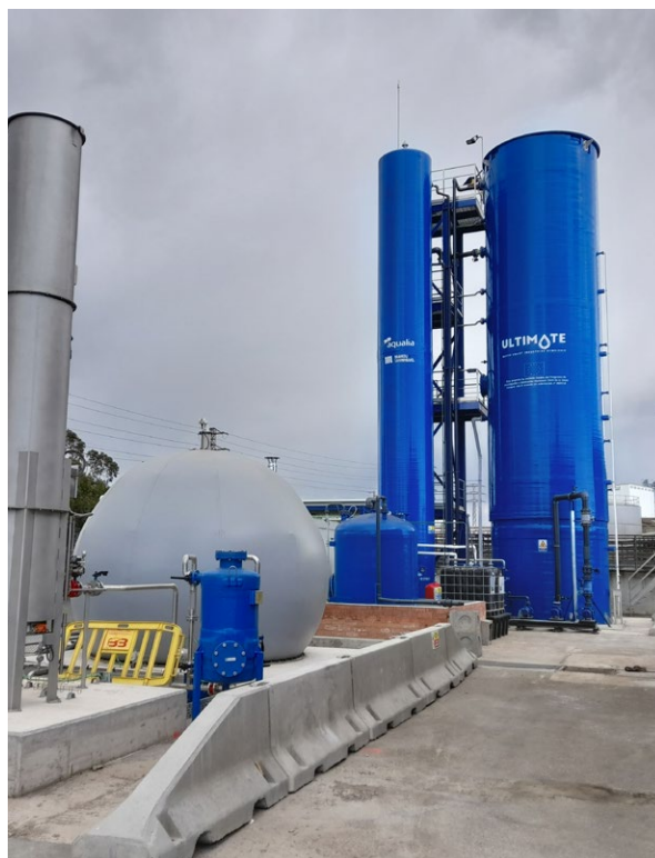
Proyecto instalado en la industria Mahou-San Miguel, Lleida, España.
