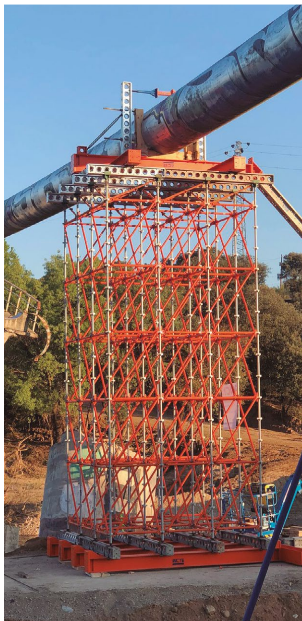
Puente que soportaba la tubería principal de abastecimiento de Picadas, Toledo, España, afectado por la DANA.
